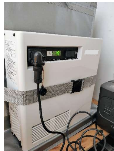
小型冷凍機の温度
