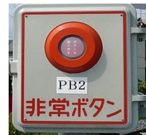
非常押しボタン
