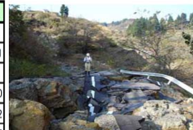
瓦礫と化した国道291号の被災状況の調査 (H16.11.6 山古志村)
