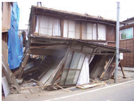
写真 5.42 倒壊寸前の建物
