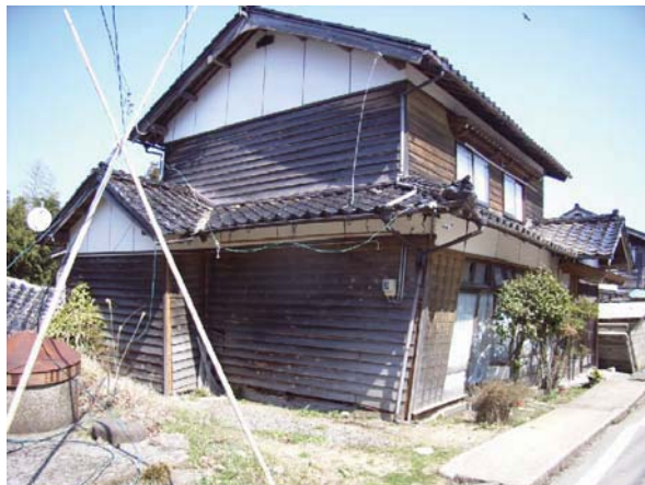
写真 5.14 道路側に大きく傾いた家屋
