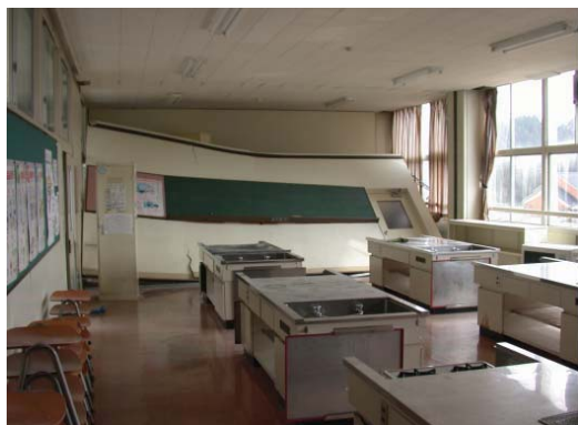
写真 7.6 間仕切り壁倒壊
