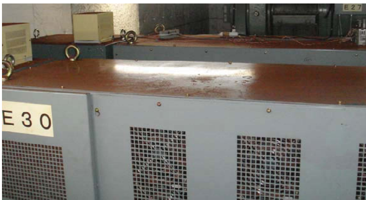
制御盤上面に飛散した赤錆粉
