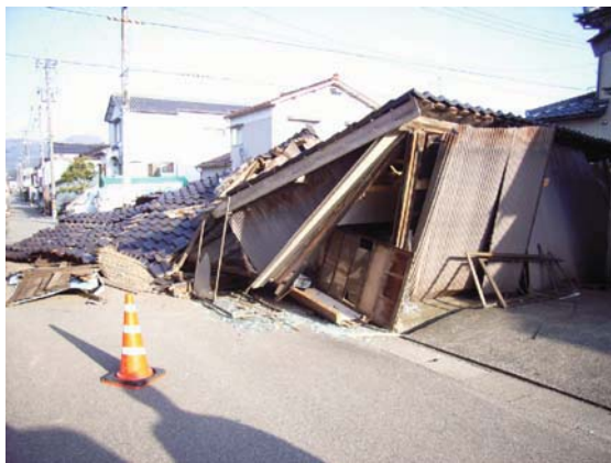
写真 5.7 1階車庫か倉庫の建物の倒壊
