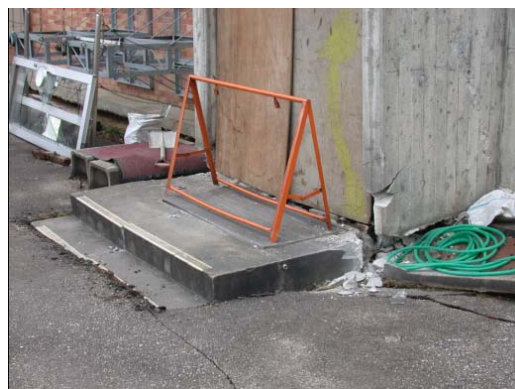
写真 6.15 建物周辺部の液状化被害
