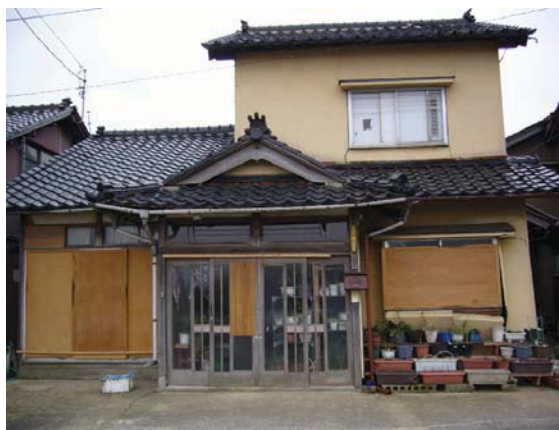
写真 5.50 国道 249 号線沿いの被害家屋
