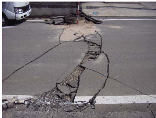
写真 6.6 総合福祉会館周辺の地盤変状
