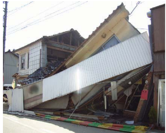
写真 5.22 倒壊した店舗併用住宅
