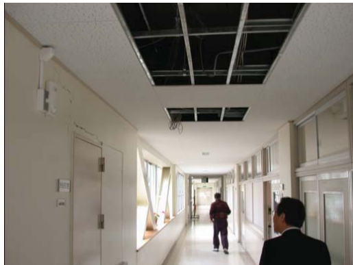
写真 6.10 校舎の廊下天井パネルの落下
