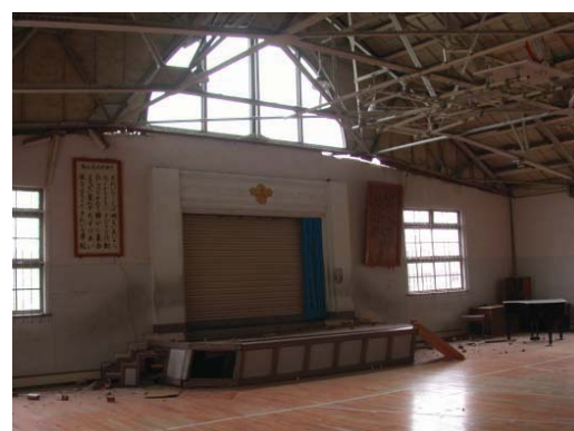
写真 6.12 講堂の妻壁部の被害
