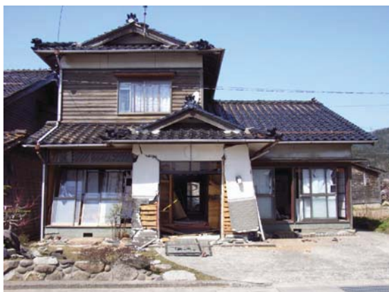
写真 5.25 外装、建具が大破した建物
