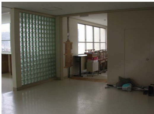
写真 6.9 校舎 EXP.J 部の被害
