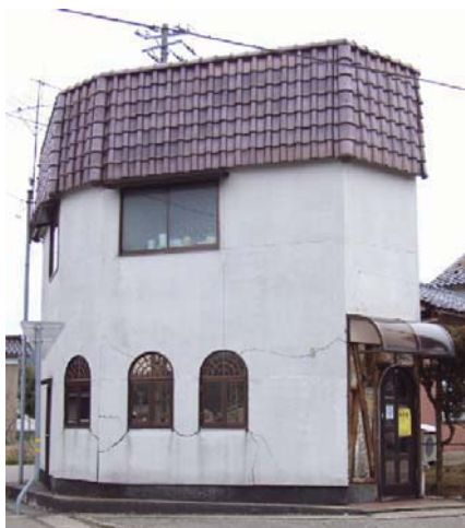
写真 5.45 躯体の腐朽が確認された店舗
