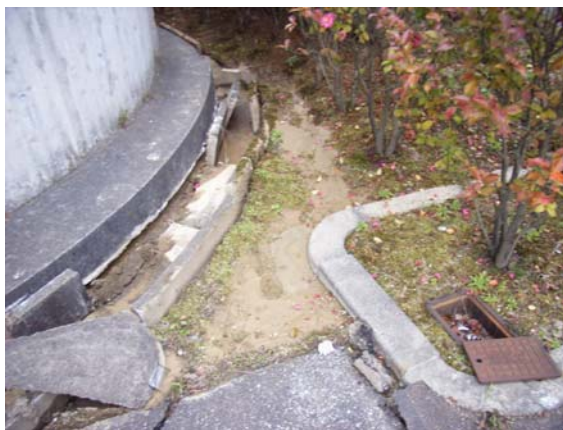
写真 5.49 田鶴浜支所裏の噴砂痕
