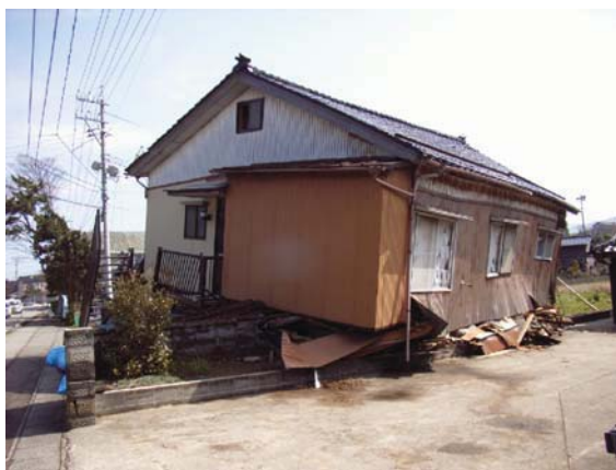
写真 5.11 小伊勢地区の倒壊家屋
