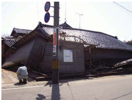
写真 5.26 比較的古い構法の倒壊家屋
