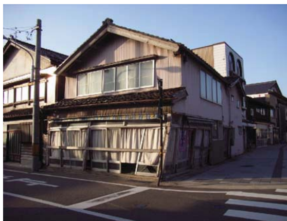
写真 5.6 大きく傾いた店舗併用住宅
