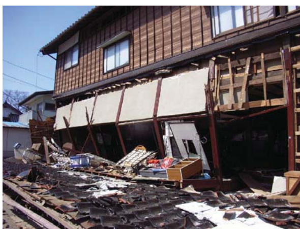
写真 5.15 倒壊は免れたが柱が折損した住宅
