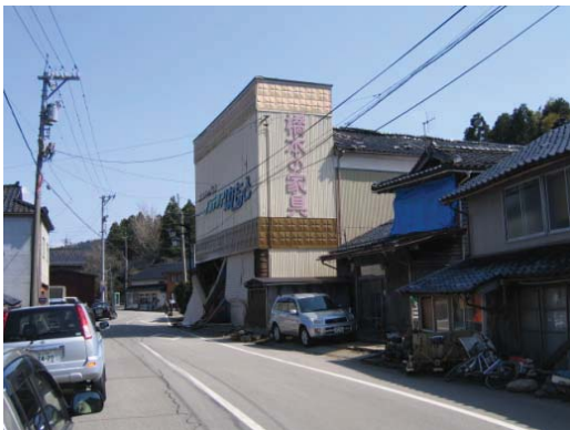
写真 7.2 大破した S 造店舗（門前地区、2 階鉄骨梁の溶接部が破断し、2 階が落下）
