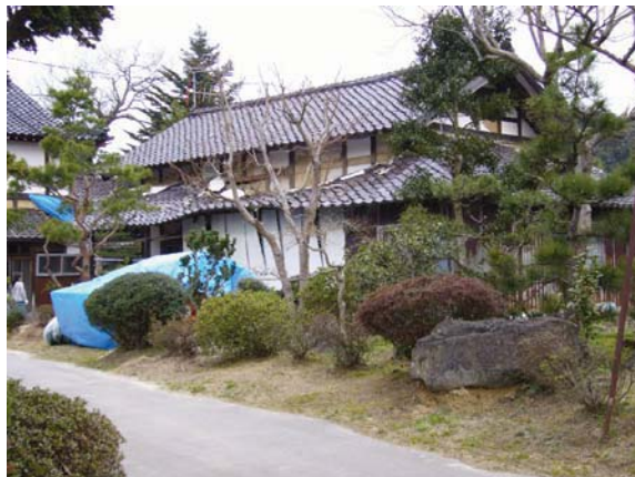
写真 5.52 奥原地区で大破した家屋
