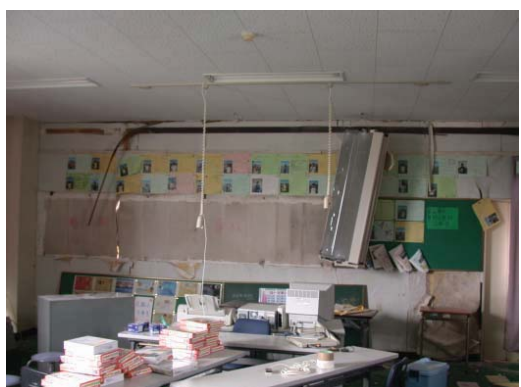
写真 7.8 妻壁被害（エアコン脱落）
