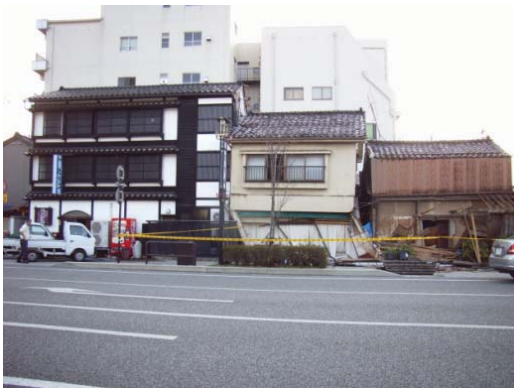
写真 7.3 大破した S 造店舗（輪島地区、1 階部が倒壊し、隣接建物に寄りかかった状態）
