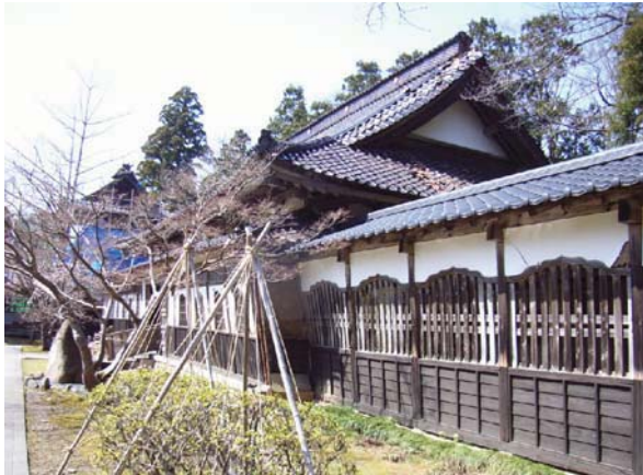
写真 5.19 被害が大きい山門左奥の建物
