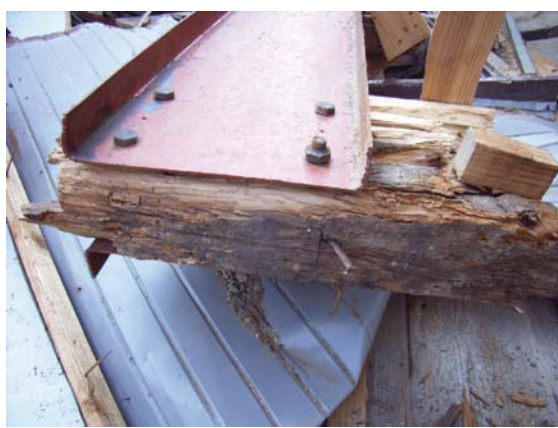
写真 5.4 左の家屋の鉄骨梁と木材柱の腐朽
