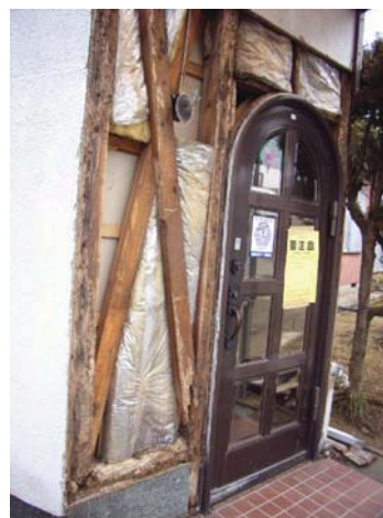
写真 5.46 木造躯体の腐朽
