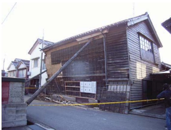
写真 5.5 倒壊寸前の土塗り壁を有する家屋
