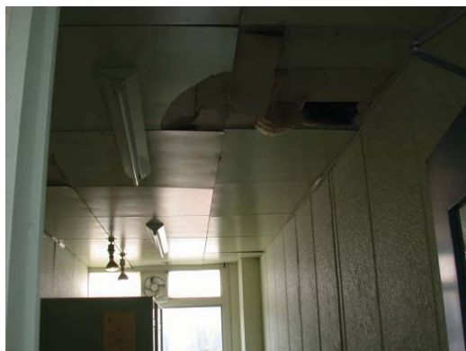
写真 7.5 天井パネル被害
