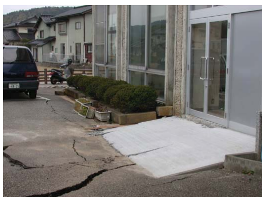
写真 6.16 建物周辺部の液状化被害
