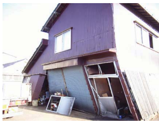
写真 5.2 倒壊寸前のチップ工場の倉庫
