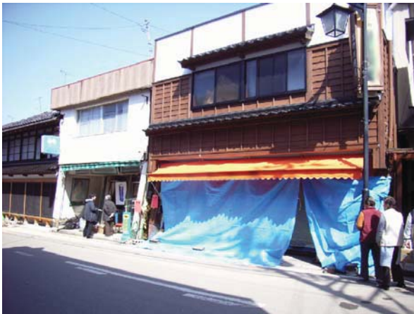
写真 5.21 大きな被害を受けた店舗併用住宅
