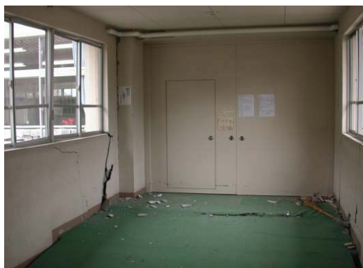
写真 6.11 校舎と講堂の渡り廊下の被害
