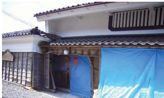
写真 5.32 残留変形が大きい住宅
