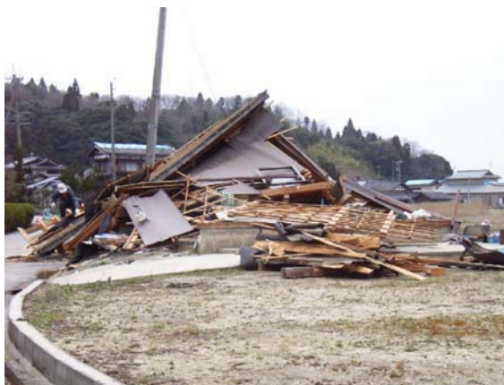
写真 5.51 倒壊した作業所または倉庫
