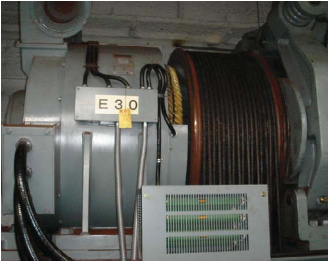
事故機 (E30号機) （シーブカバー外した状態）
