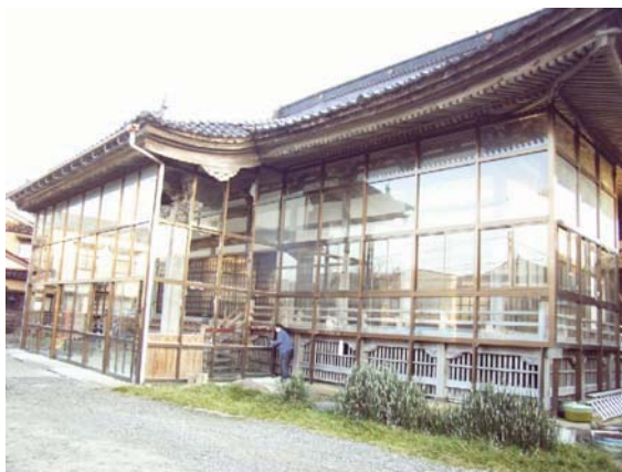
写真 5.9 カーテンウォールの被害
