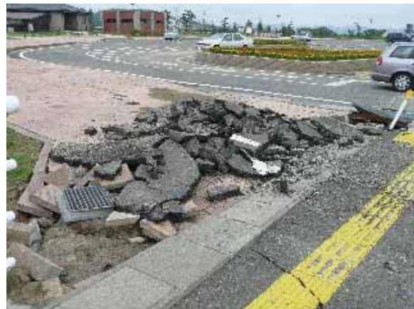
写真 5.40 鯖石川記念公園駐車場へ続く地面のひび割れ
