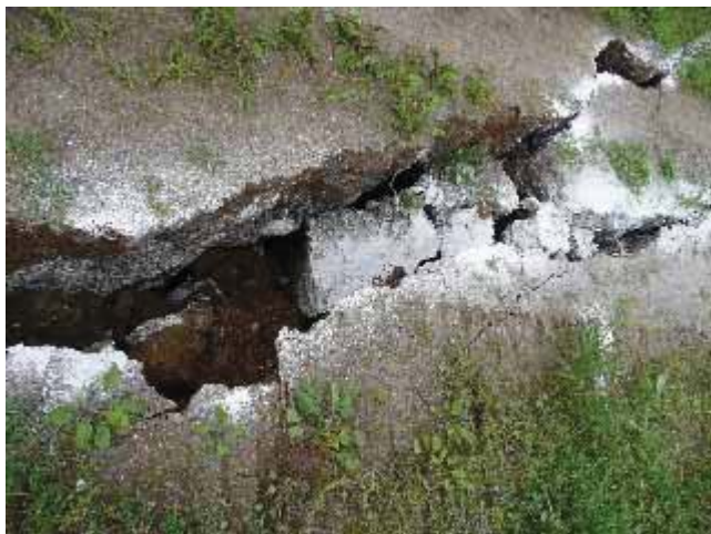
写真 5.45 鯖石川記念公園北側の土手を貫くひび割れ（深さ 1 m 以上）の北端部付近
