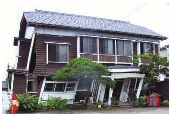
写真 5.13 残留変形が多きい総2階の木造
