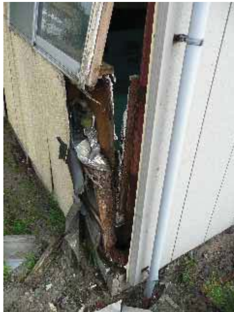
写真 5.50 写真 5.49 の裏側の被害
