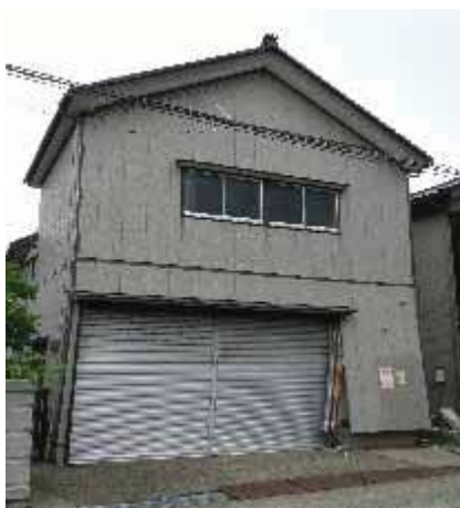
写真 5.37 1階が大きく傾いた車庫
