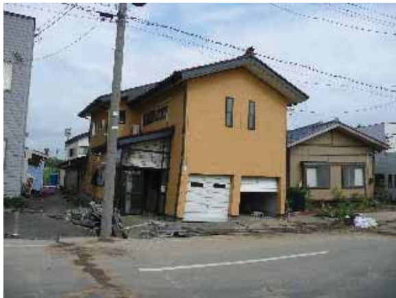
写真 5.47 地盤変状により大きな被害を受けた 木造住宅
