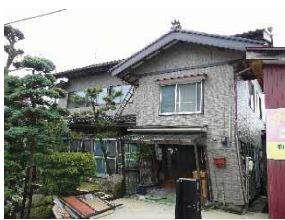
写真 5.20 残留変形が大きい住宅
