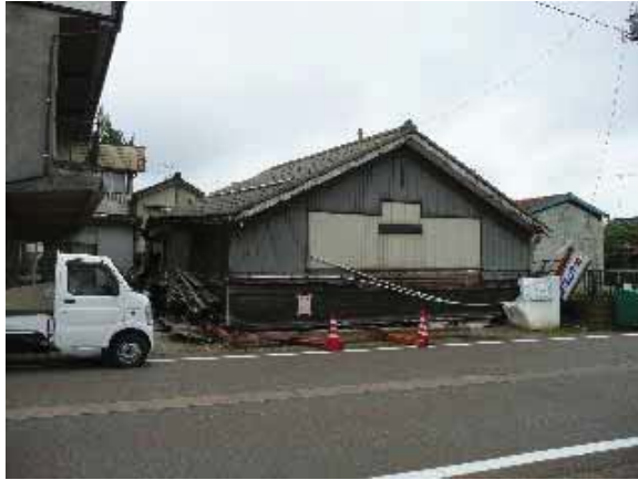
写真 5.33 倒壊した店舗併用住宅
