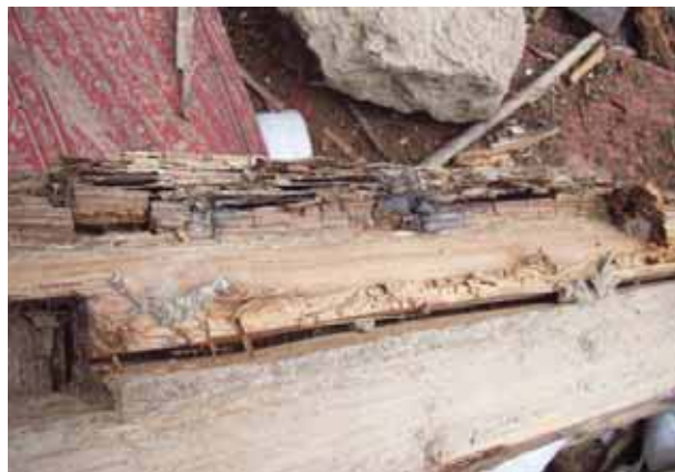
写真 5.16 写真 5.15 の建物の部材の腐朽・蟻害
