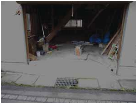
写真 5.7 写真 5.6 の土間コンのひび割れ
