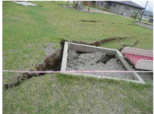
写真 5.42 鯖石川記念公園の遊具施設を貫く 地面のひび割れ
