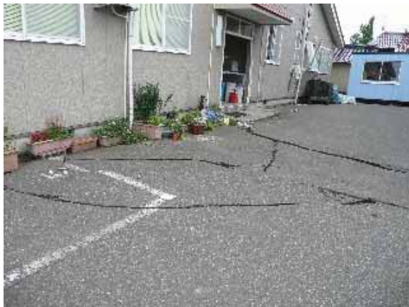
写真 5.39 写真 5.38 の北北東へ続くひび割れ
