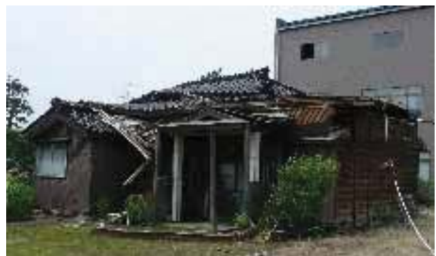
写真 5.29 2階が崩壊した例
