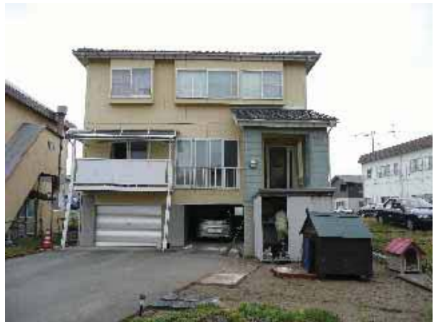
写真 5.48 地盤変状により大きな被害を受けた 高床式木造（1 階部分 RC 造）
