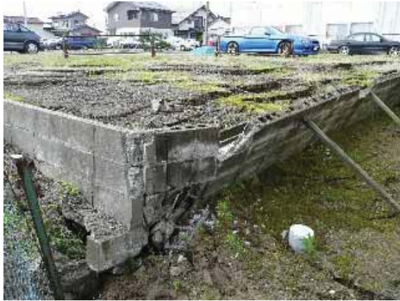
写真 5.37 駐車場地面のひび割れと擁壁の崩壊
