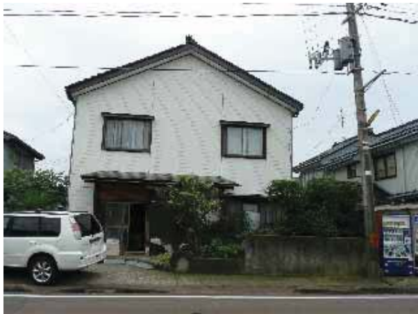
写真 5.21 残留変形が大きく残る住宅
