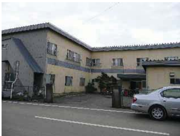
写真 5.49 一部損壊（裏手部分）した軽量鉄 骨造
