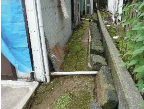
写真 5.25 写真 5.23 の敷地の変状
