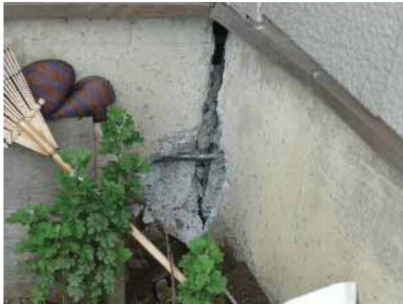
写真 5.53 写真 5.50 の建物の破壊された基礎
