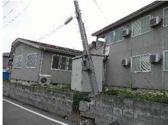
写真 5.54 写真 5.50 の建物の敷地の擁壁の崩壊
