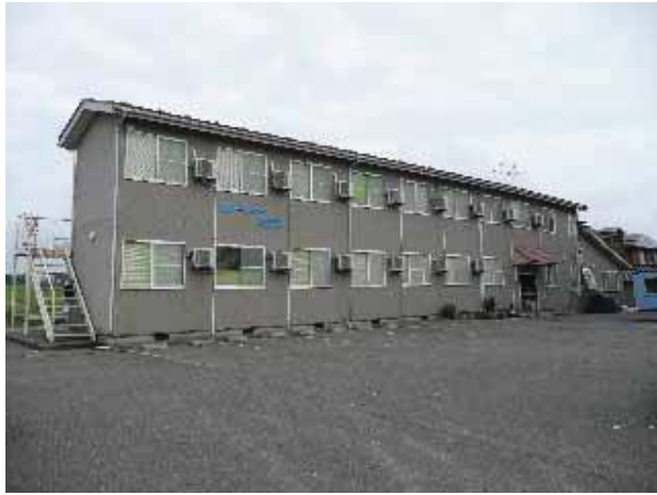
写真 5.51 一部損壊（裏手部分）した木造共同住宅
