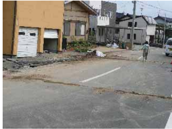
写真 5.38 アスファルトを貫くひび割れ (写真 5.37 の北東方向)
