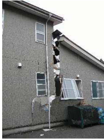
写真 5.52 写真 5.50 の下屋部分の継ぎ目部の破壊
