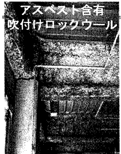
吹付けアスベスト
