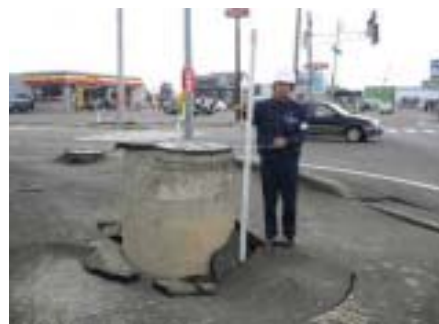
新潟県中越地震の被害
