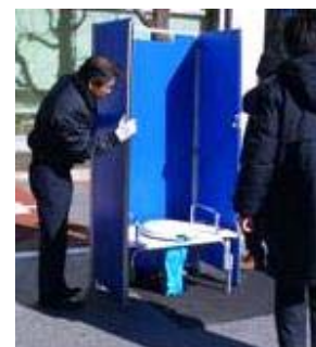
マンホールに直接接続する 仮設トイレ
