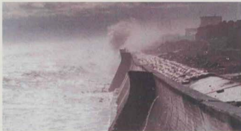
海岸侵食により砂浜が失われ、越波・決壊の被害が多発している胆振海岸（苫小牧市）
