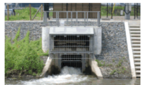
綾瀬川への導水状況
