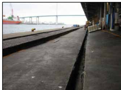
博多漁港における被災状況
