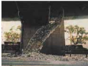
橋脚部の被災 (兵庫県南部地震)
