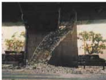
橋脚部の被災 (兵庫県南部地震)
