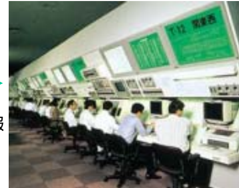
航空交通管制部管制室
