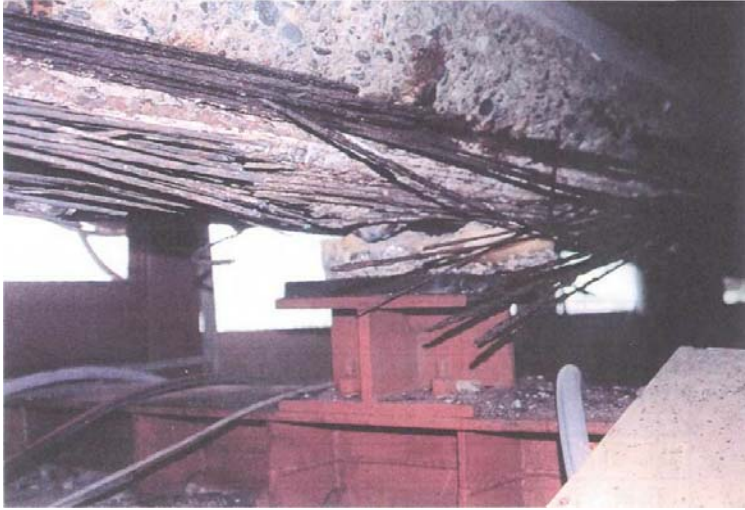
塩害による主桁PC鋼材の破断(国道7号芦川橋(秋田県)、竣工:昭和41年)
