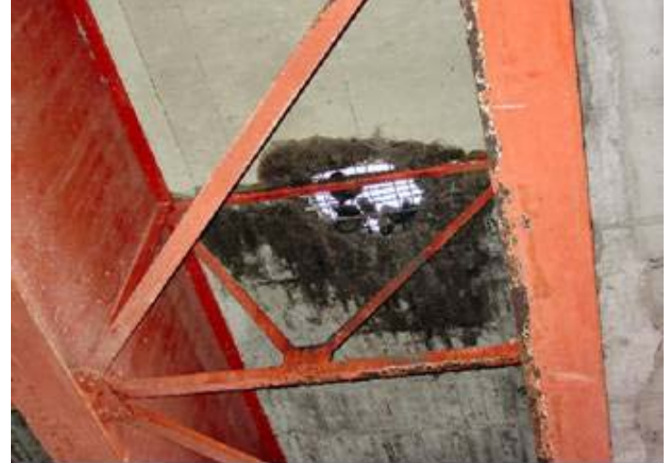
RC床版の疲労による抜け落ち(国道4号白河橋(福島県)、竣工:昭和36年)
