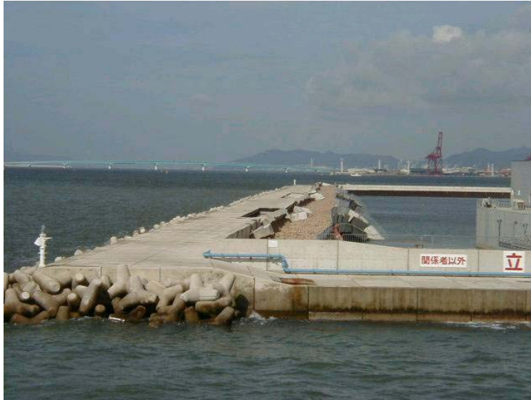
南護岸の被災状況
