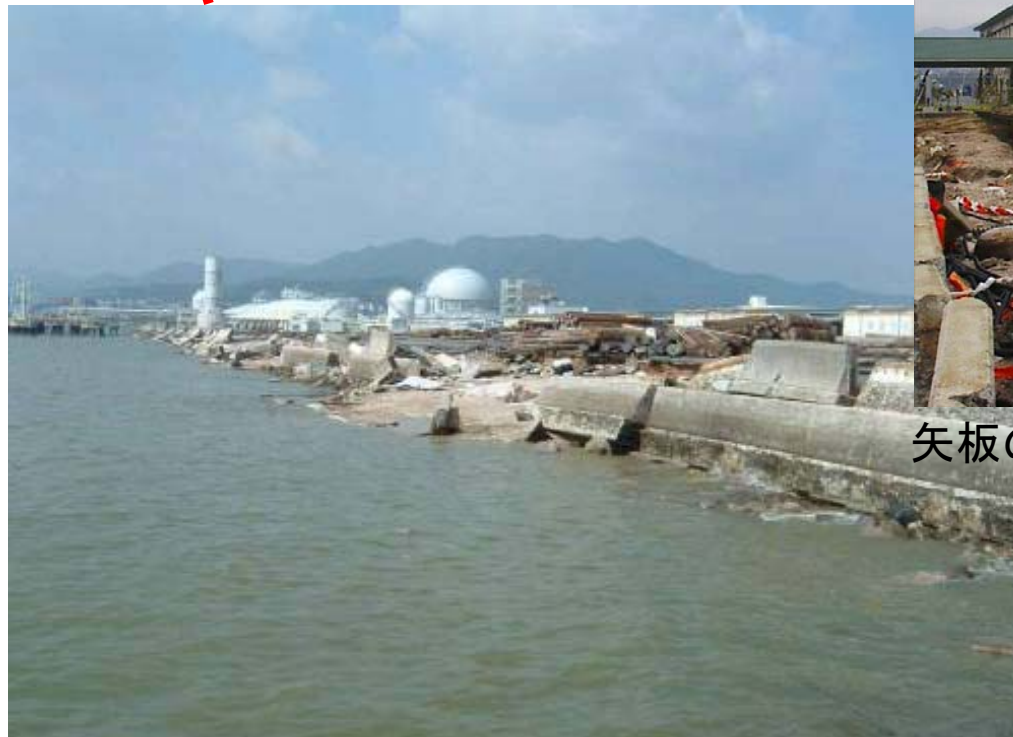
高波浪による護岸の崩壊
