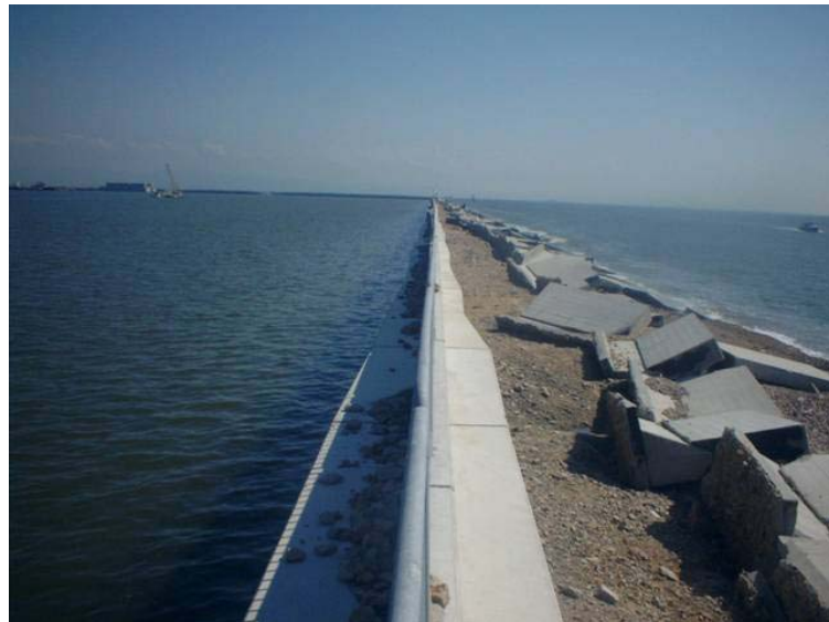
西護岸の被災状況
