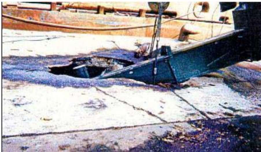
【岸壁エプロンの陥没部分】
