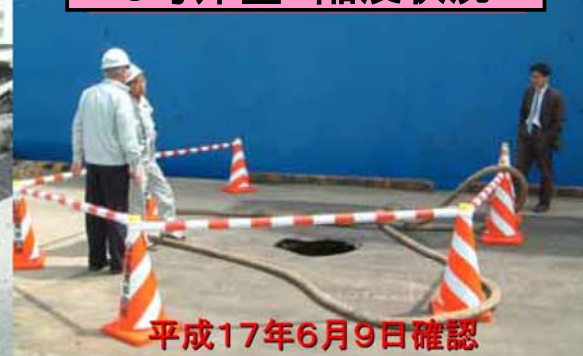
3号岸壁 陥没状況
