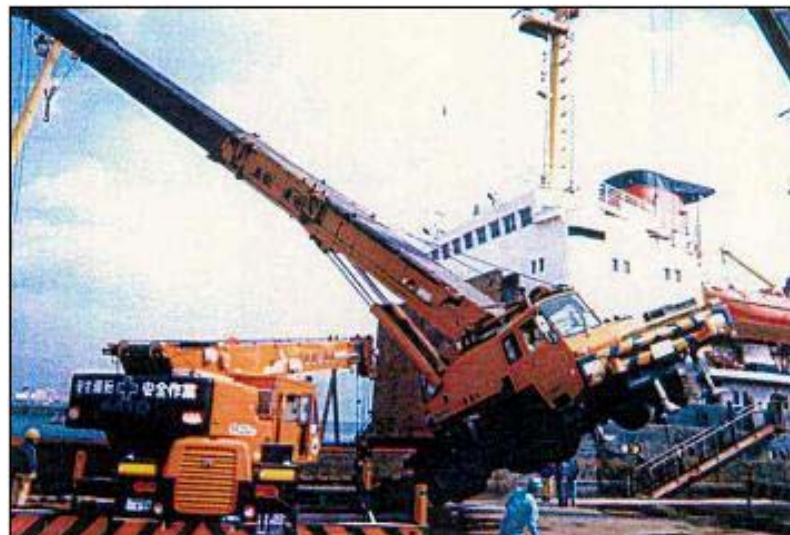
【岸壁エプロンの陥没により傾いたクレーン】
