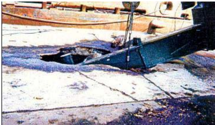
【岸壁エプロンの陥没部分】
