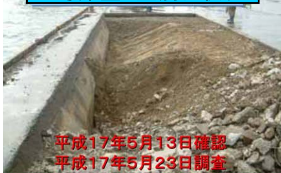
2号岸壁 空洞化状況
