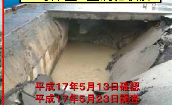
3号岸壁 空洞化状況
