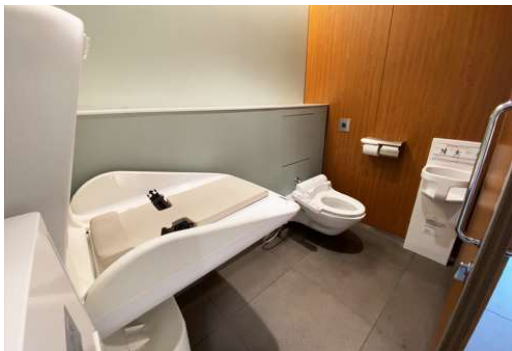
⑤ カートのまま入れる便房（入口付近に設置）
