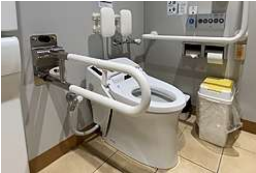
②オストメイト用簡易水栓設備と背当てのついた便器
