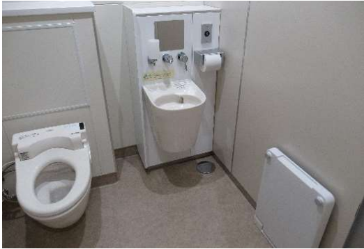
⑤男女別一般トイレ内のオストメイト用設備付便房
