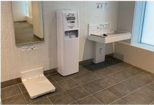
⑦洗面台付近に設置されたおむつ交換台と着替え台
