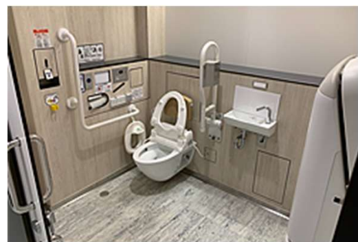
②一般トイレ内の車椅子対応便房 (写真は岡崎サービスエリア上り線男性トイレのもの)
