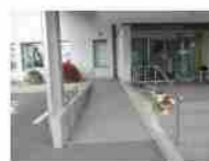
出入口の段差解消 事業費：30万円程度
