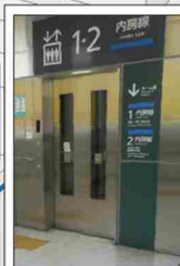
エレベーター
