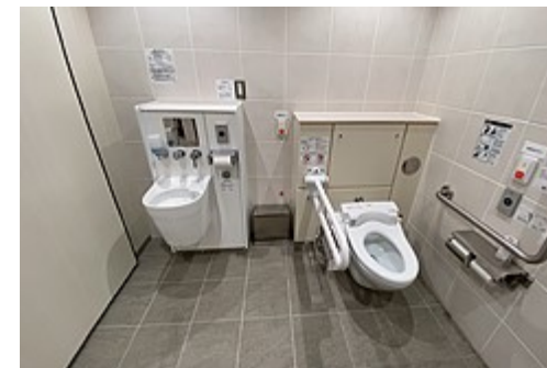
一般トイレの車椅子利用者用簡易型便房 (オストメイト用設備も設置)
