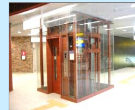
エレベーター
