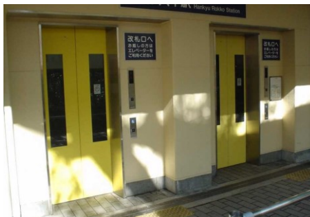
（旅客施設のエレベーター）
