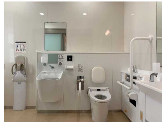
オストメイト施設付きトイレ（「道の駅」くしま）
