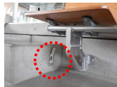
集団補聴設備の設置
