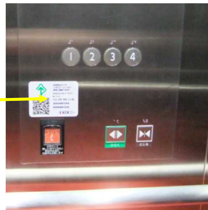
エレベーターカゴ内 操作盤に2次元バーコード が貼付られている
