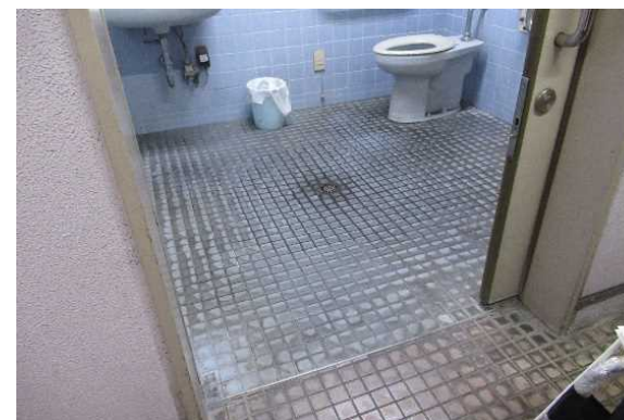
トイレ入口の扉が閉まりづらい オストメイト用の設備がない
