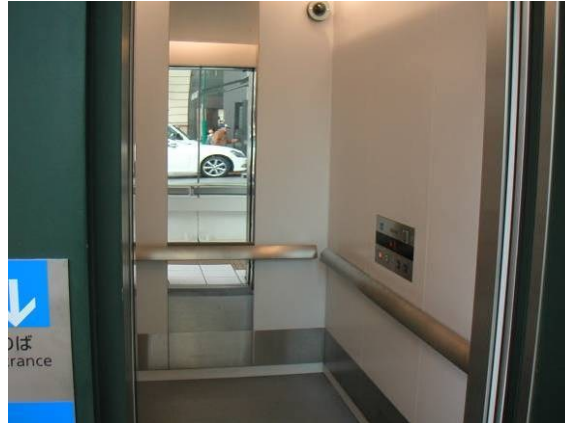
参考 2-1-26：かご内正面に低い位置まで鏡を設置したエレベーターの例 ＜福岡市交通局 七隈線エレベーター＞
