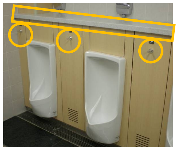
小便器の横に設置される例
