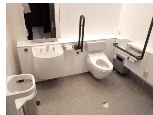
多機能トイレ オストメイト対応トイレ
