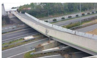
＜緊急輸送道路上の橋梁の崩落＞
