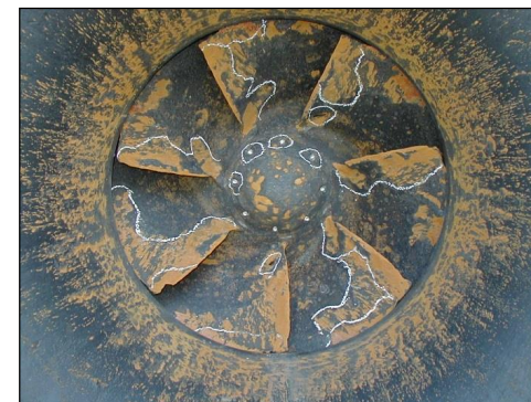
腐食した排水ポンプ場の羽根車
