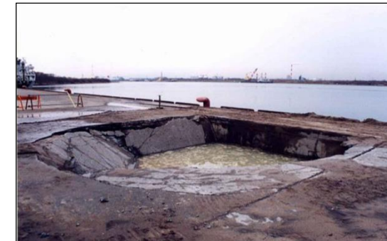
陥没した港湾施設のエプロン
