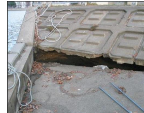
クラックが生じた河川護岸
