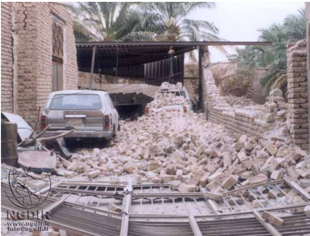
写真1 . 2003年12月バム地震(イラン)での被害状況 壁の崩壊形態に注目: 日干しレンガがバラバラに分離、崩壊している。
