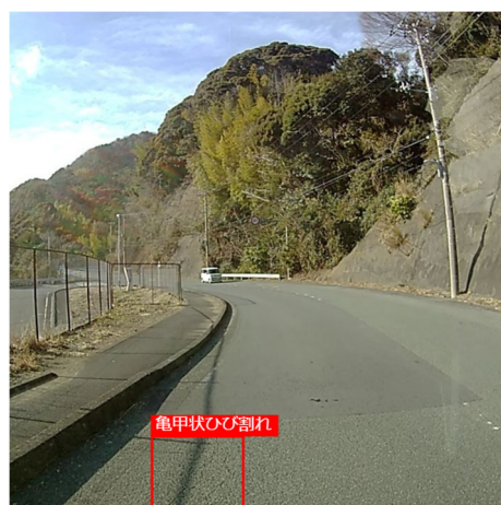
図 4-84. 検知結果(亀甲状ひび割れ)
