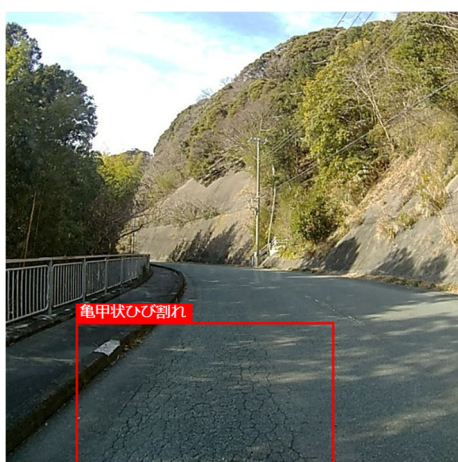
図 4-83. 検知結果(亀甲状ひび割れ)
