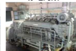
例：自家発電機の整備
