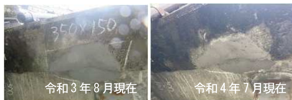
図-7 簡易補修箇所の継続的なモニタリング
