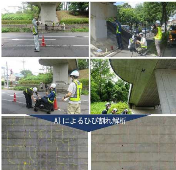
図-8 画像計測と AI によるひび割れ解析
