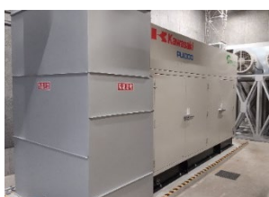
【非常用発電設備】
