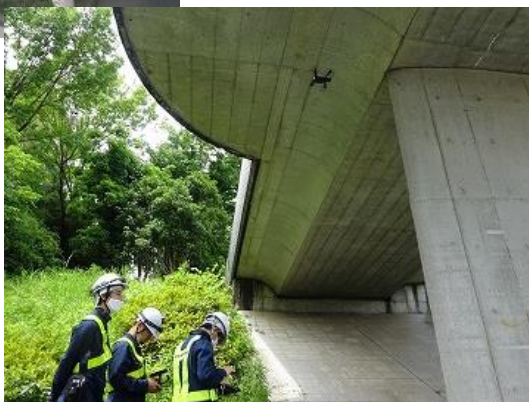
【ひびわれデータ取得状況】
