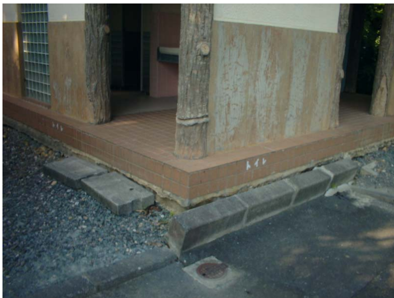
トイレ出入り口での段差状況
