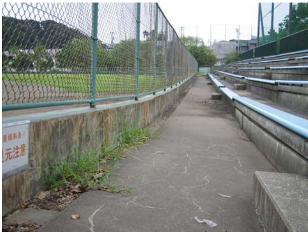
●地盤沈下に伴う野球場のスタンド・ダッグアウト等の破損
