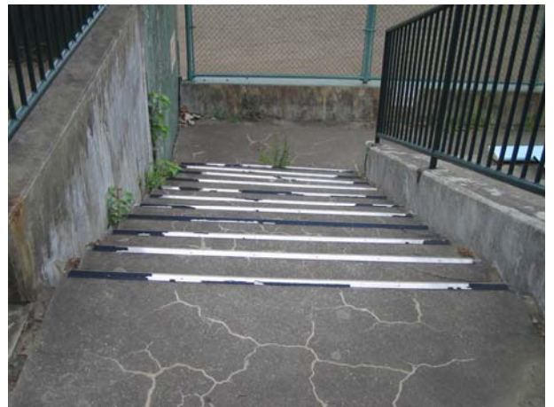
●野球場の構造物の老朽化・劣化
