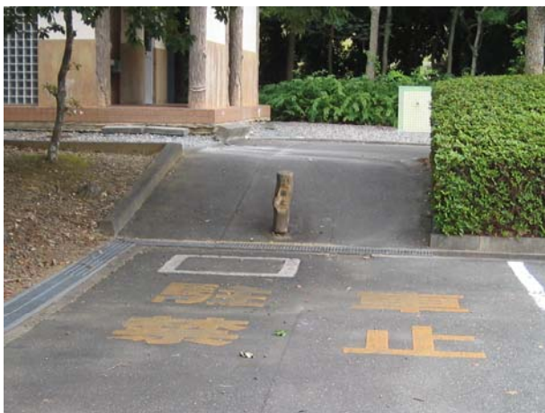
●スロープの急勾配による弱者に対するバリア
