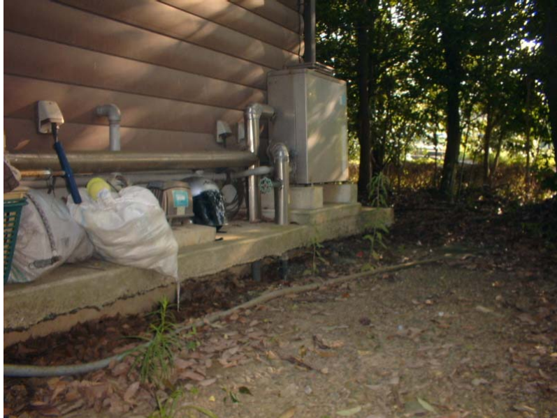
管理棟給排水施設の状況。犬走りが浮いた状態。
