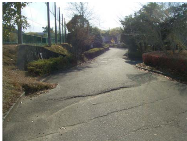
●通路の舗装の不陸と劣化
