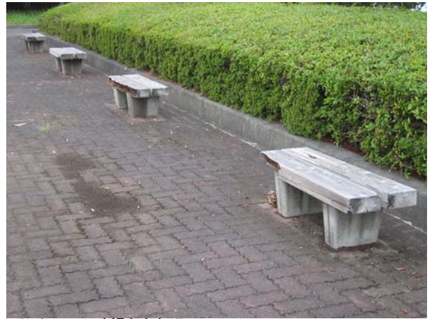
●ベンチの破損と老朽化
