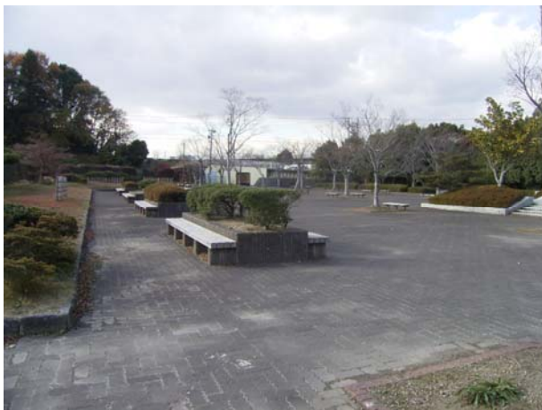
●エントランス広場の舗装の退色と劣化
