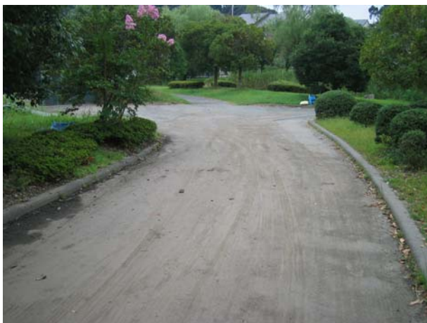
●排水施設の流下能力の不足(土砂の堆積)
