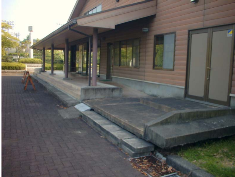
管理棟段差状況
