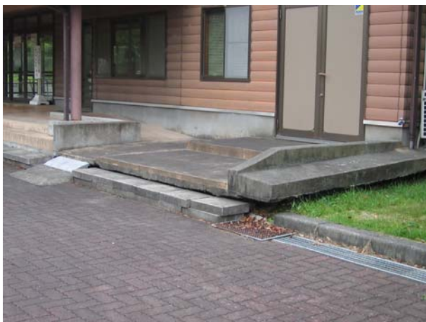
●地盤沈下に伴う階段の不具合
