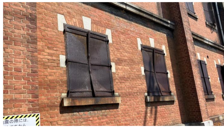
(変形した鉄扉)
