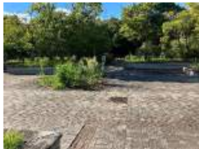
③植栽樹 随所に植栽樹がつけられており、草が繁殖している。
