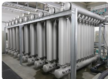
上水処理設備
