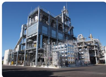
汚泥処理設備
