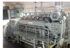
例：自家発電機の整備
