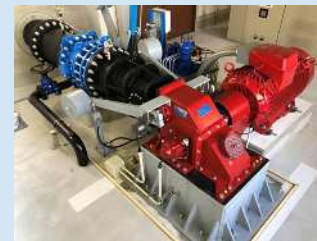
【長野県安曇野市】 三郷黒沢川小水力発電 自主事業：JV企業として事業実施中
