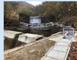
【山形県米沢市】 米沢大平小水力発電 自主事業：JV企業として事業実施中
