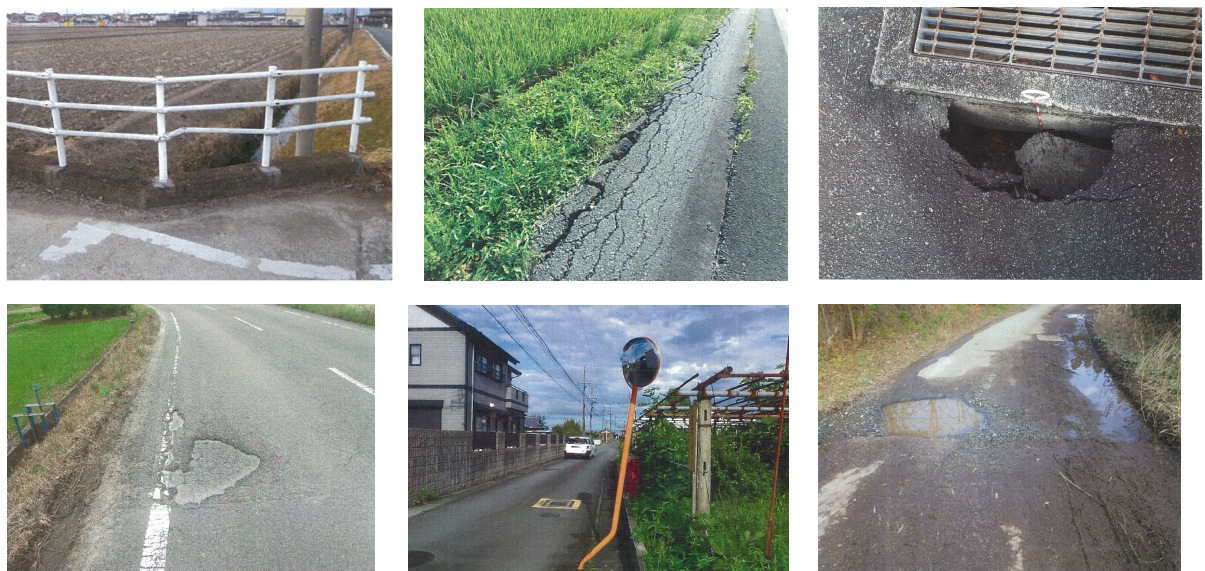
図 7-2 包括管理業務の対象となる道路施設等の損傷状況
