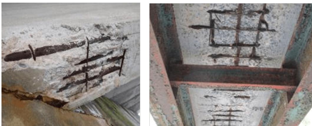
図 5-2 鉄筋露出・腐食の状況
