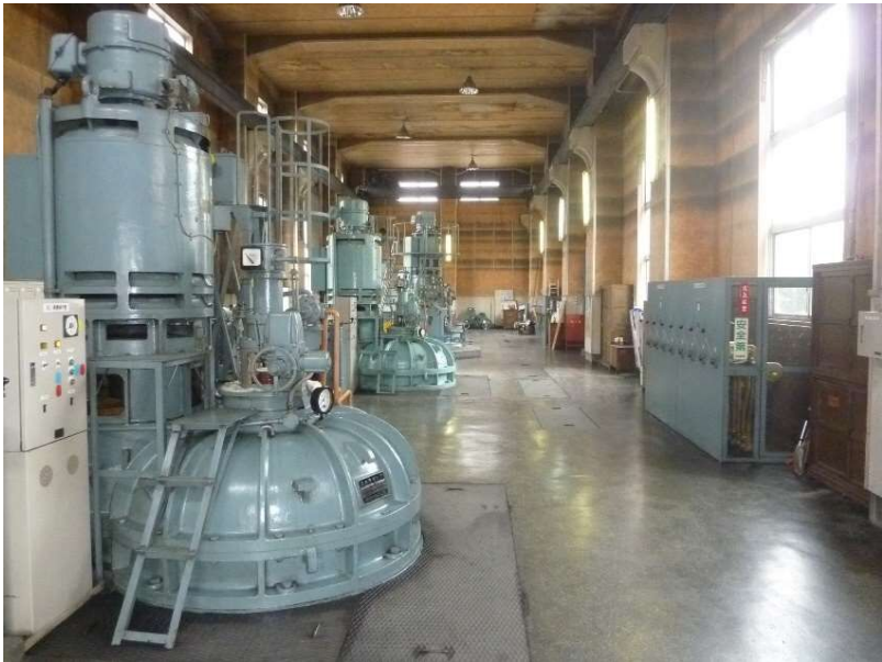
写真（旧松重ポンプ所内）
