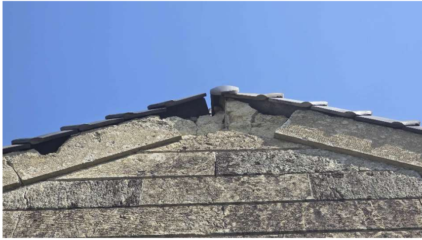
土蔵 屋根損傷
