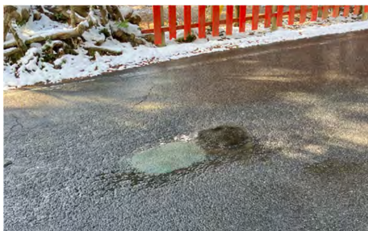
図 8-3 繰り返しの応急補修跡
