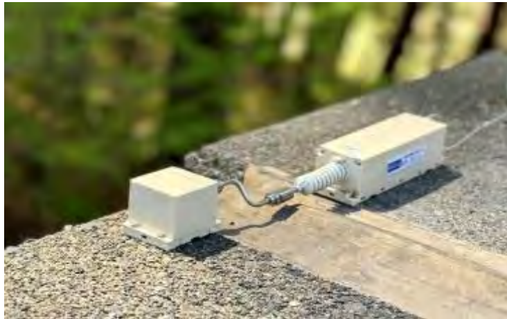
図 4-14 IoT センサーの外観と設置例
