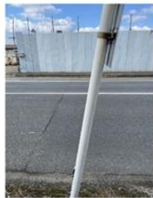
写真-2 〈3-105〉 標識変形、支柱傾き
