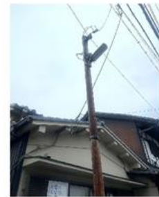
写真-4 〈4-38〉 支柱全体の腐食
