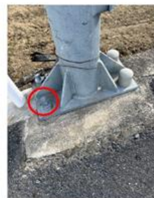
写真-3 〈4-15〉 支柱基部ボルトカバー破損
