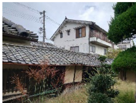
図表 2-9 屋根瓦の劣化（中庭）
